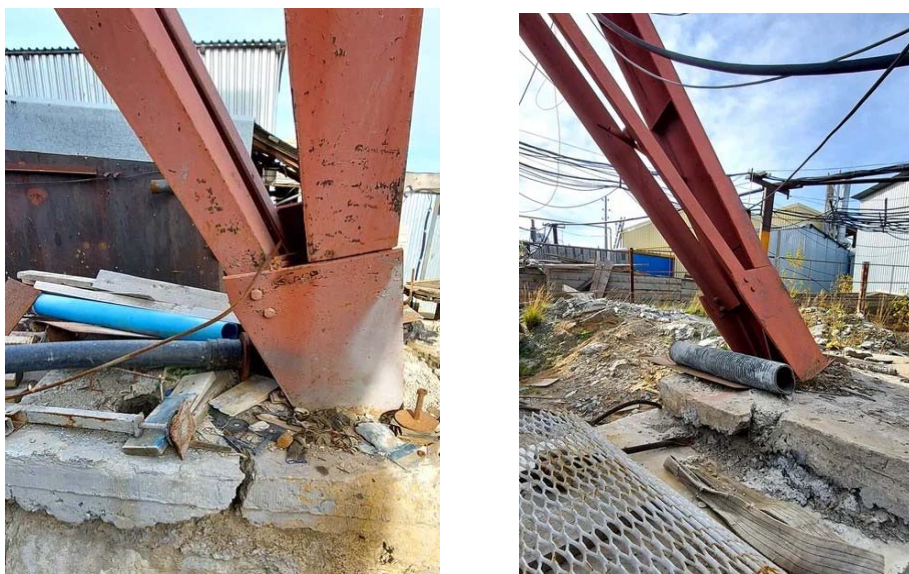
Рисунок 44 - Разрушение бетонных опор укосин копра ствола «Вспомогательный»
