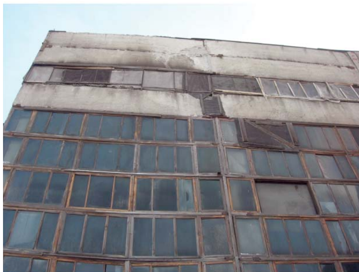
Рис. 3. Пострадавшие от взрыва здания: а – фасад части здания школы № 4 (стекла треснули в двух окнах справа на 1-ом этаже и во втором окне слева на 3-ем этаже); б – фасад производственного корпуса котельной № 9 (вместо разрушенных стекол проемы закрыты толем, железом, полиэтиленовой пленкой)
